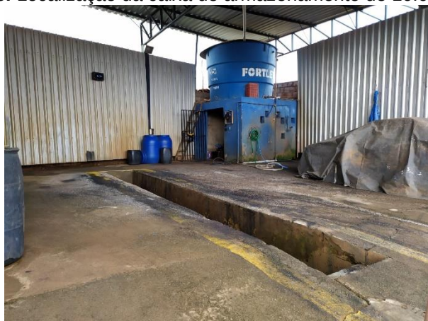
Foto 03: Localização da caixa de armazenamento de 10.000 litros.
