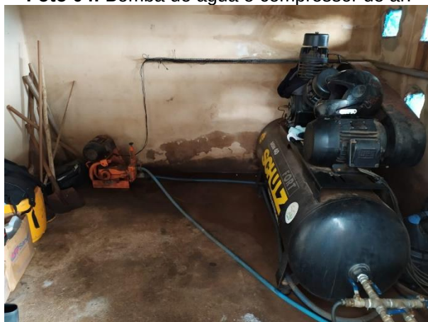
Foto 04: Bomba de água e compressor de ar.
